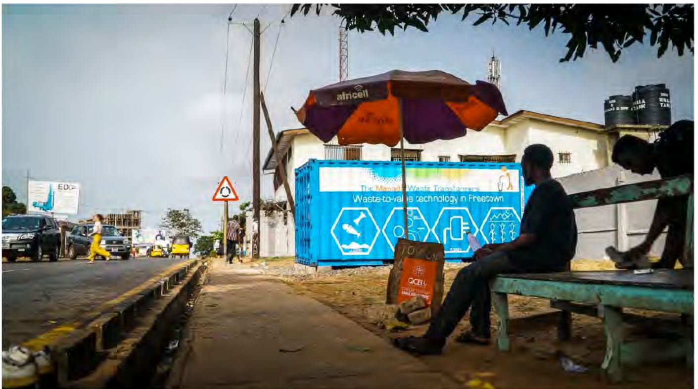
In Freetown, de hoofdstad van het doodarme Sierra Leone, leveren Waste Transformers elektriciteit aan een vrouwenziekenhuis.
